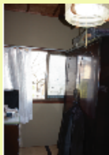
1間の窓の一部の壁。弱い事が判明
